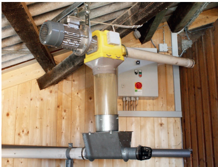
Übergabestation mit transparentem Ablaufrohr
